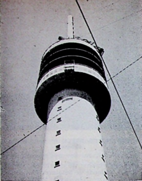
TORENTOP MET PLATFORMS en de nog in aanbouw zijnde antenne
